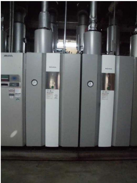
小型ボイラー
